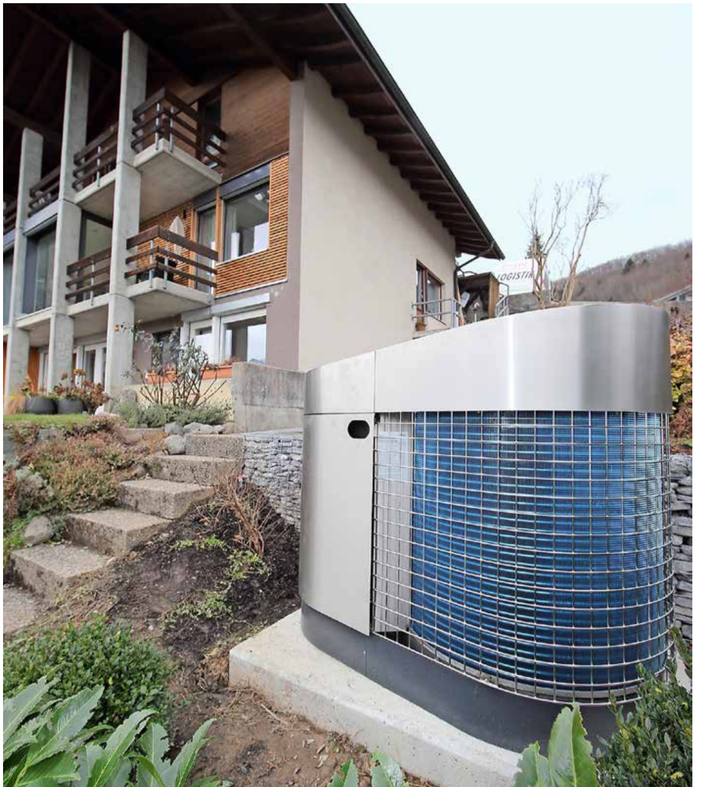
Kleine Abstände zu Balkonen und Schlafräumen sowie zu den Nachbarn erfordern Wärmepumpen mit äusserst niedrigen Dezibelwerten.
